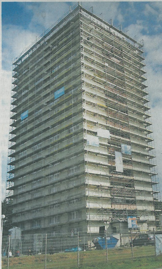
Die Bauarbeiten an der Beuthener Straße laufen auf Hochtouren. Im Juni 2016 sind die Hochhäuser fertig. Foto: Weigert
